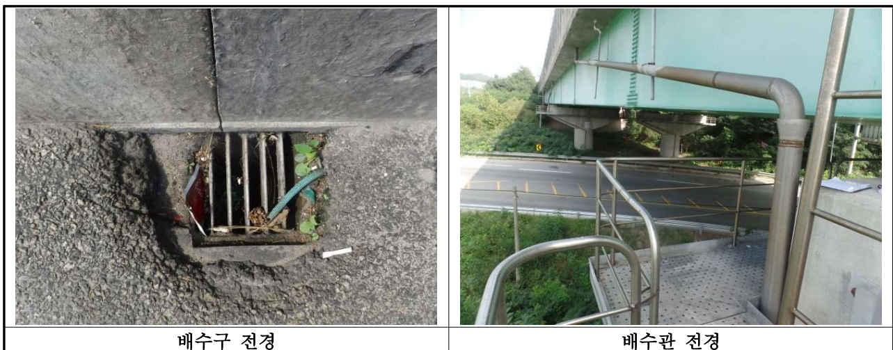
【그림 3-11】 배수시설 현황(마산방향)
